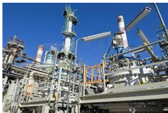
©usinouvelle – Raffinerie Fos
