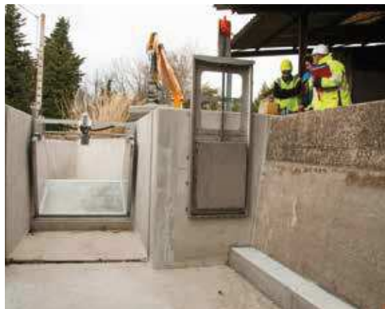
Modernisation du Canal Saint-Julien, dans le Vaucluse
