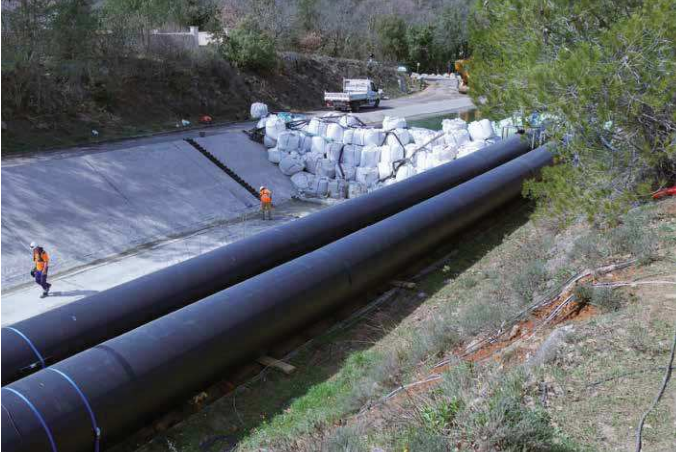
Reprise de l'étanchéité et des drains du canal au niveau de Saint-Maximin, dans le Var
